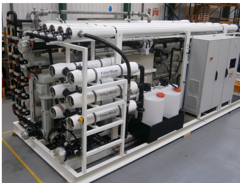
Impianto ad osmosi inversa
