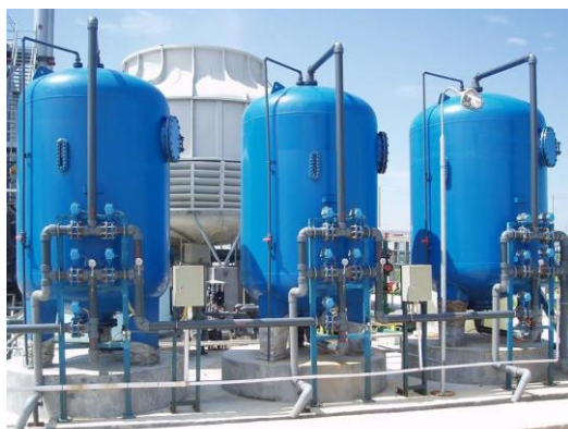
Foto di un pre-trattamento di un osmosi inversa con i filtri a sabbia
