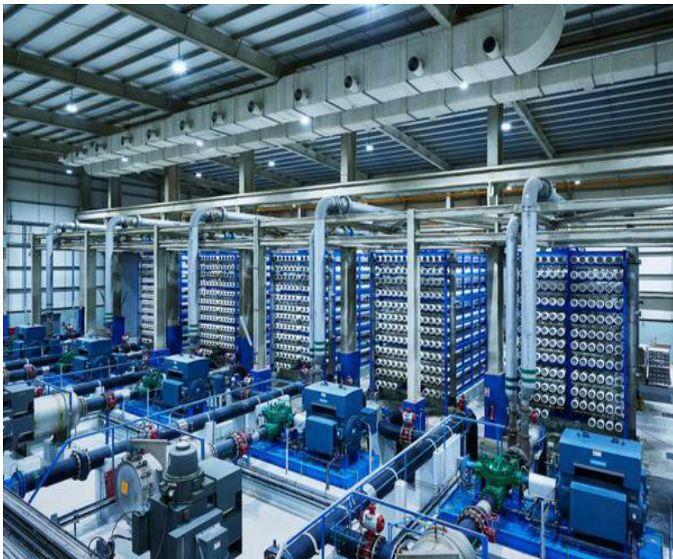
Foto impianto ad osmosi inversa.
