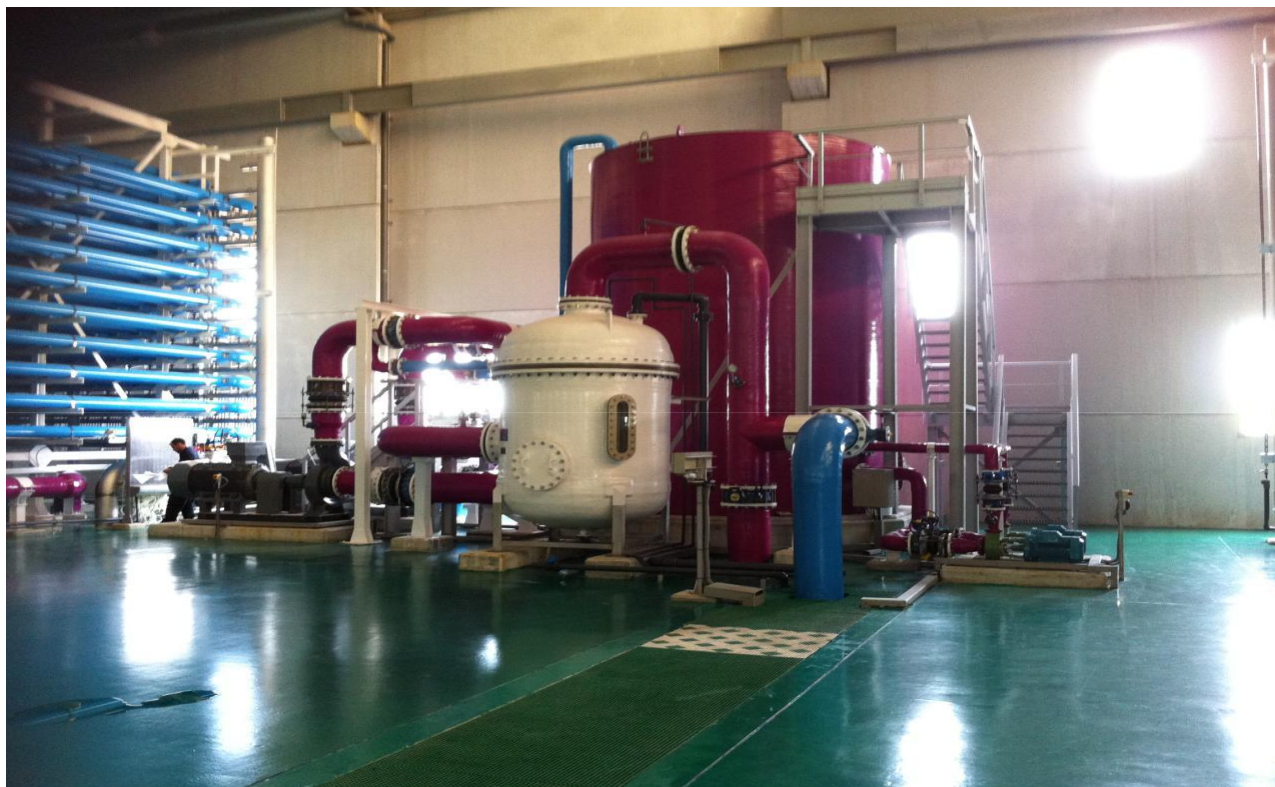
Foto sistema di lavaggio impianto ad osmosi inversa
