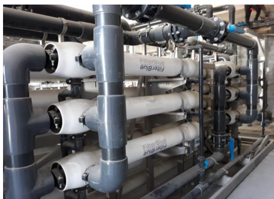
Foto di un pre-trattamento di un osmosi inversa con i filtri a cartuccia
