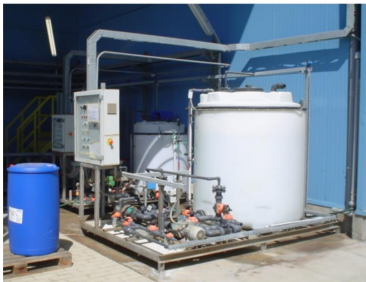
Foto impianto di dosaggio antiprecipitante EVERBLUE
