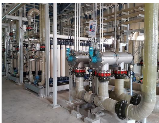
Foto di un pre-trattamento di un osmosi inversa con i filtri autopulenti ed i moduli di ultrafiltrazione
